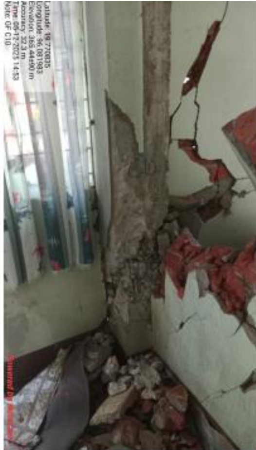
GF - C10 (Severe)
