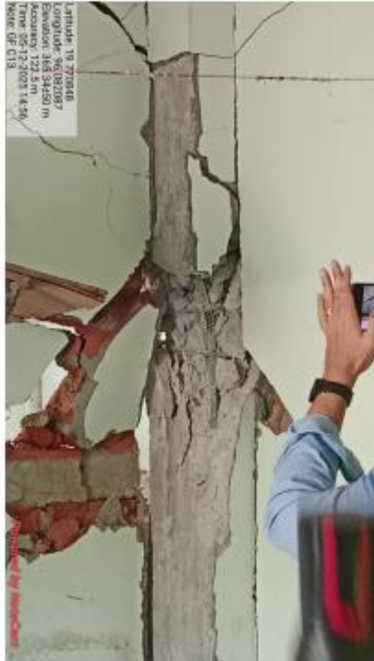
GF - C13 (Severe)
